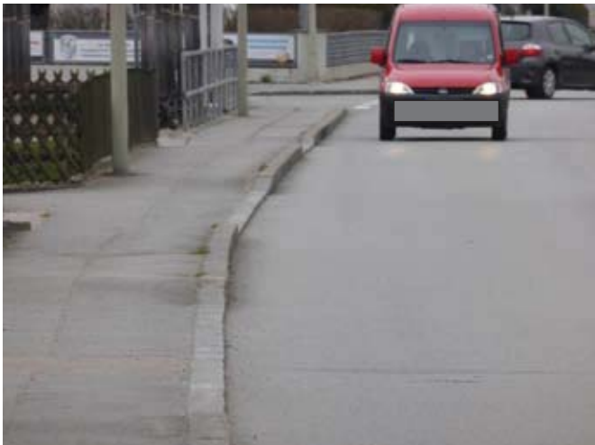
Abb. 2.40 Gehweg Bahnhofstraße: Unebene Oberfläche
