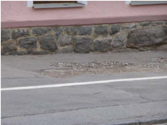
Abb. 2.39 Marktplatz: Beschädigter Gehwegbelag
